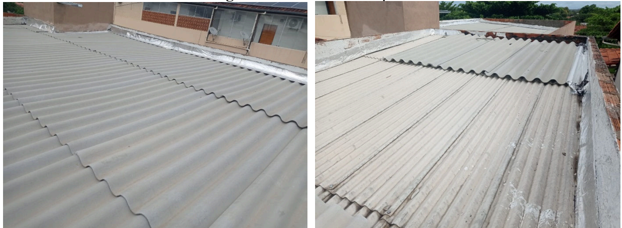
Imagem 5: Falta de rufo na parede
