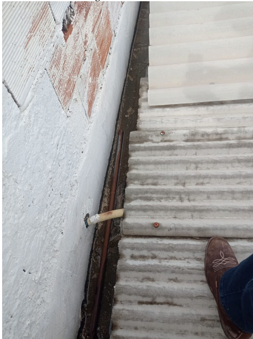
Imagem 1: Falta de calha
