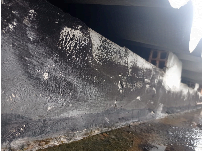
Imagem 2: Falta de calha
